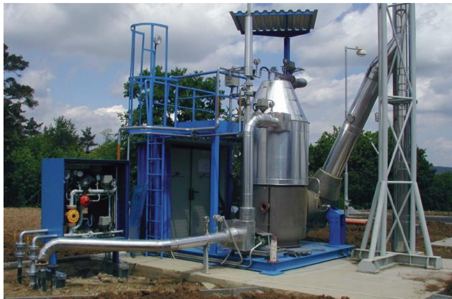
Obr. 1: Spalovací zařízení pro zneškodňování odpadních plynů pro MND Drilling & Services a.s.
