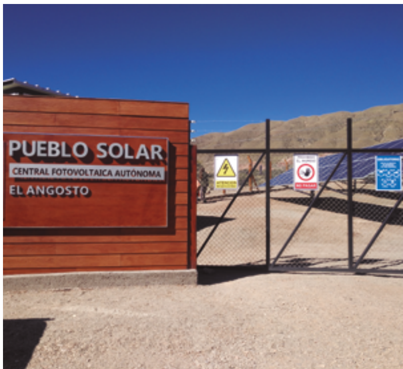
Central fotovoltaica de El Angosto, Jujuy. M. NIEDER.
