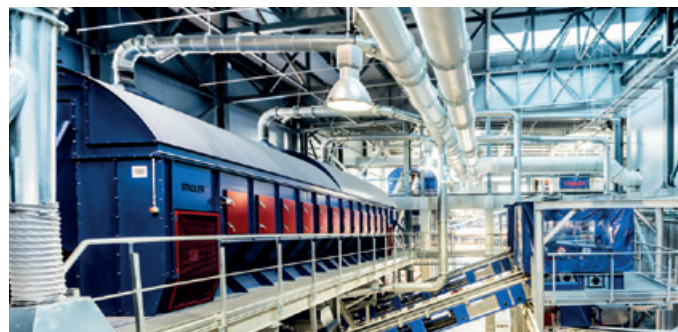
Μονάδα Διαχείρισης Απορριμμάτων Ηλείου
