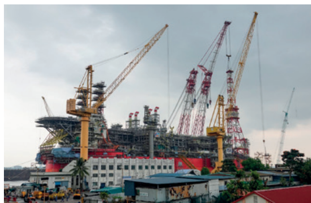
Το FPSO «Energean Power» έτοιμο κατά 95% περίπου στα ναυπηγεία Admiralty της Σιγκαπούρης
