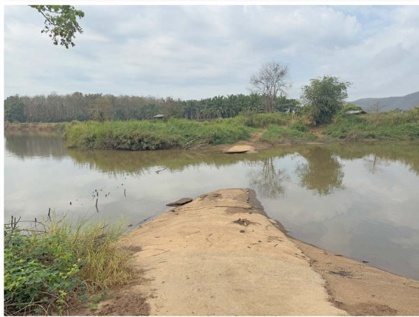
อาคารฝายน้ำล้นเดิมที่ชำรุดและใช้การไม่ได้ Existing Overflow Weir Structure in Deteriorated and Non-Operational Condition
